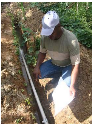
Réseau de distribution de l'eau d'un micro-aqueduc à El Valle
